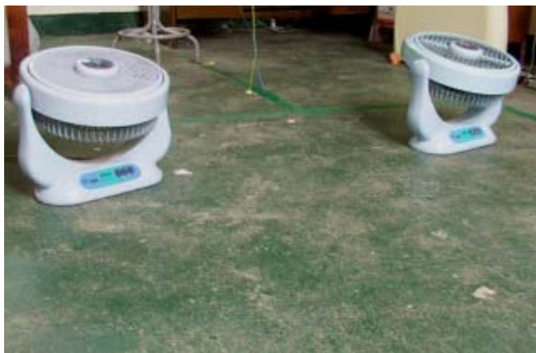
Fig. 11 Circulation using fan
